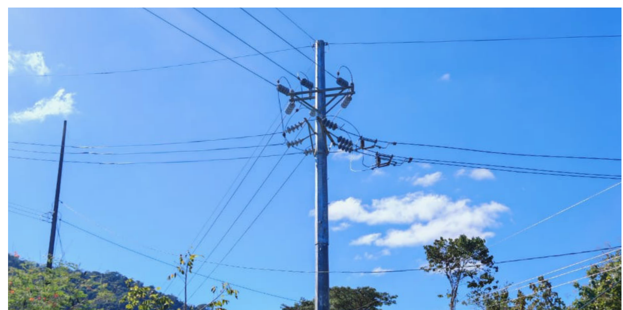
Postes y líneas de distribución en Nosara, cantón de Nicoya.
